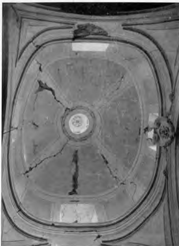
MELFI, CATTEDRALE: LA CUPOLA DOPO IL TERREMOTO DEL 23 LUGLIO 1930 (Fot. Soprint. Reggio Calabria)
